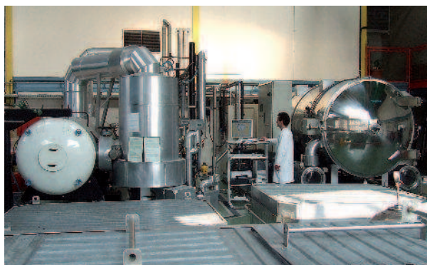
Les installations de lyophilisation.
