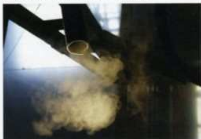
Dispositif de climatisation
